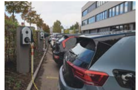
Das Lastmanagementsystem steuert über 30 AC- und DC-Ladestationen von unterschiedlichen Herstellern.
