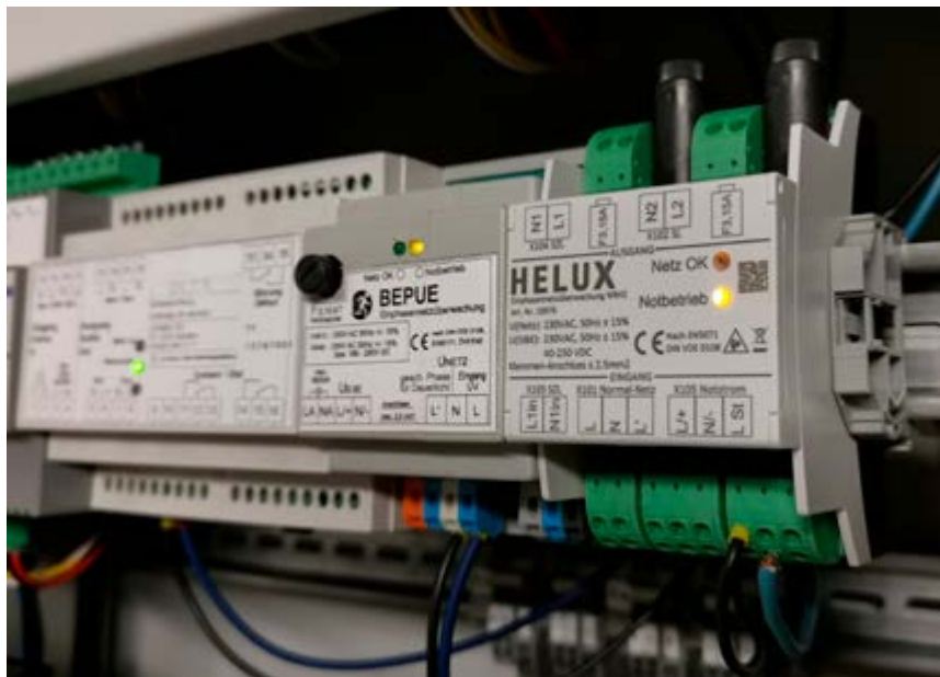
Nouveau relais NRH2 pour test CA et CC (à droite) à côté de deux relais tiers avec moins de fonctions.
