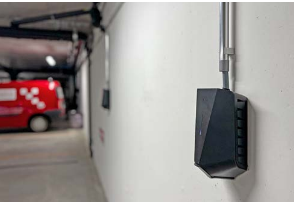
Ein grosser Teil des heute ungenutzten Marktpotenzials liegt in Mehrfamilienhäusern, wo bislang die fehlende Zustimmung der Eigentümerschaft die Hauptbremse war.
