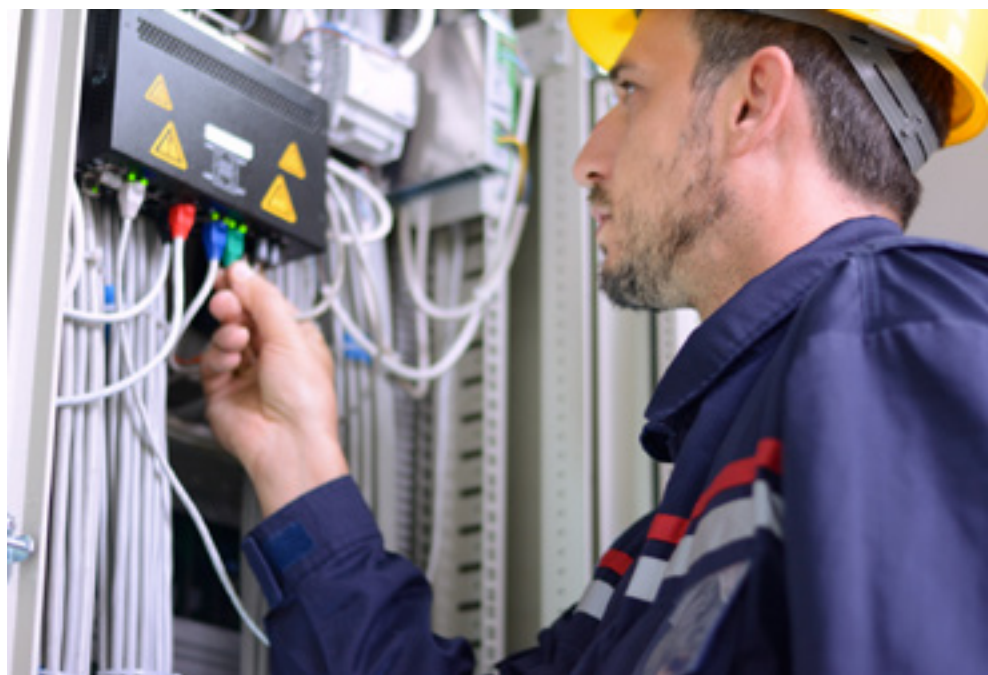
Wo früher ein Stromkabel genügte, laufen im Schaltschrank heute zahlreiche Datenleitungen zusammen – saubere Verkabelung wird zur eigenen Disziplin.
