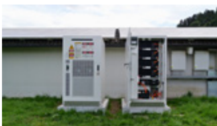
Les accumulateurs commerciaux du Sagihof.
